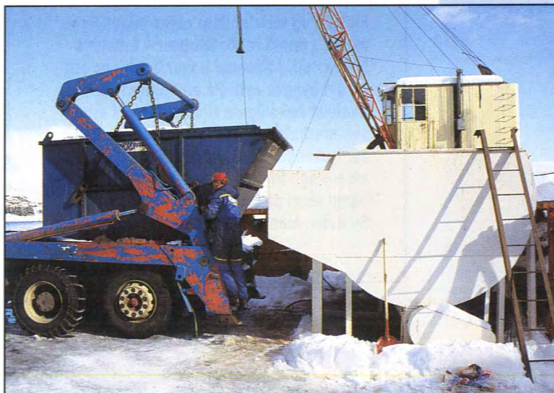
Hordafôr har etablert containerordning for de mottakene som leverer slo og avfall til Brettesnes
