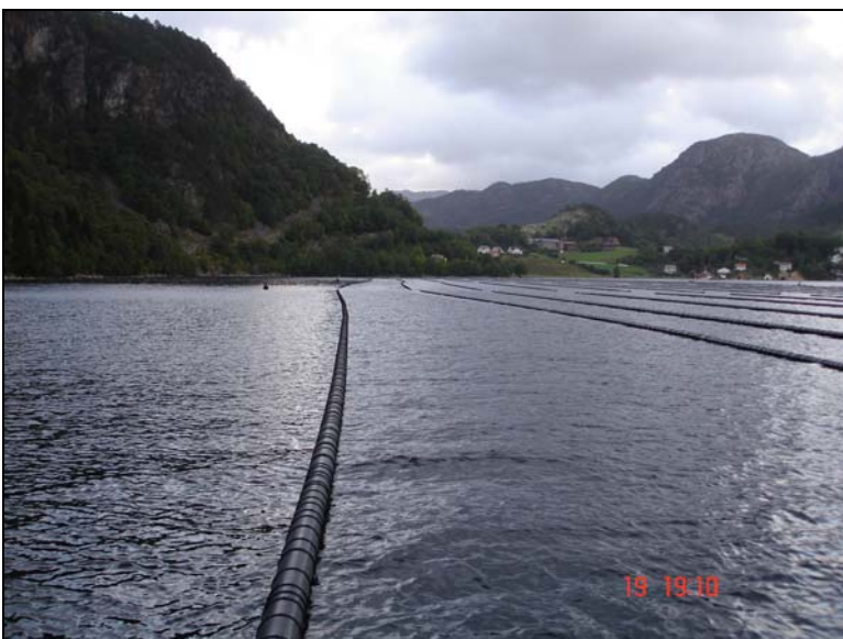
Bilde 4.3 Nessa i Hjelmeland, SmartFarm AS røranlegg.
