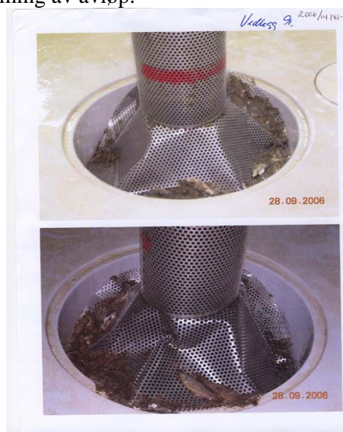
Figur 3: Sil etter kollaps
