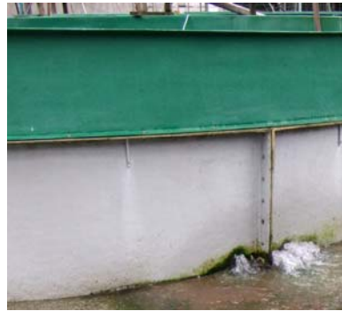
Figur 5: Kar med økt vegghøyde (og lekkasje)
