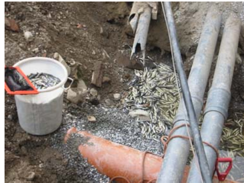
Figur 10: Uhell på grunn av feil rørkobling
