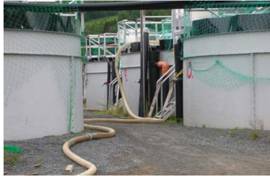
Figur 31: Føringsslanger på kryss og tvers av veien
